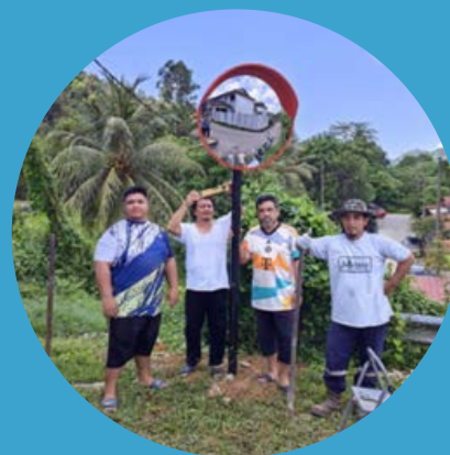
Miroirs convexes installés pour offrir une meilleure visibilité aux intersections problématiques
